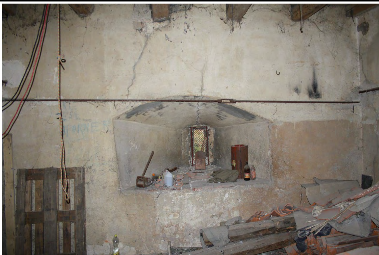
Jižní strana prvního patra věže v pohledu od severu. Foto: Jaroslav Skopec, 2013.
