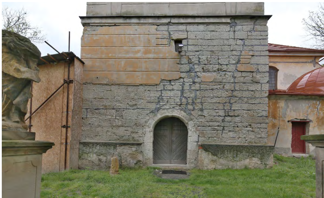
Západní průčelí věže na úrovni přízemí a prvního patra se vstupním portálem a odhalenou strukturou zdiva, které ve velkém množství druhotně využilo románských kvádrů. Foto: Marta Pavlíková, 2021.
