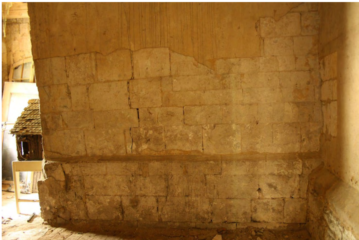
Čelní pohled od jihu na spodní část lícové plochy jižní románské zdi lodi při jejím jihozápadním nároží. Foto: Jaroslav Skopec, 2014.
