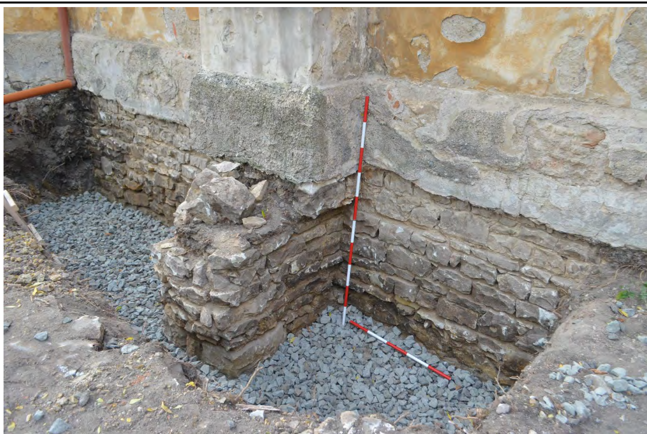
Střední část jižní strany mariánské kaple s odhaleným základovým zdívem osového opěrného pilíře, který byl druhotně využit jako základ pro současný náhrobek. Foto: Vojtěch Peksa, 2017.
