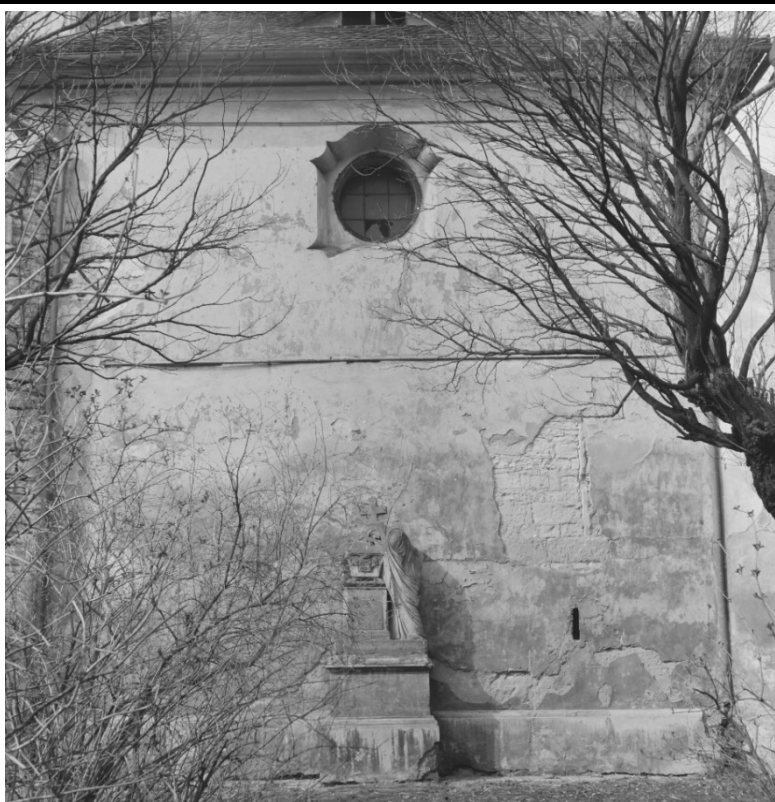
Jižní průčelí Mariánské kaple v pohledu od jihu. V místě opadané omítky je patrná hrana východní stojky východního hrotitého okenního otvoru, která dosedá na kvádr náležející patrně průběžné podokenní římsě, jejíž profil byl odstraněn, a lze předpokládat, že byl shodný s profilem římsy západní strany kaple. Foto: 1967, sbírka negativů NPÚ ÚOP v Ústí n. L., sign. 27641.
